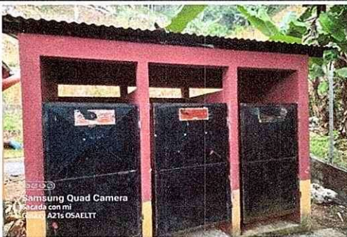
Foto 5: Pintada de puertas por deterioro.
